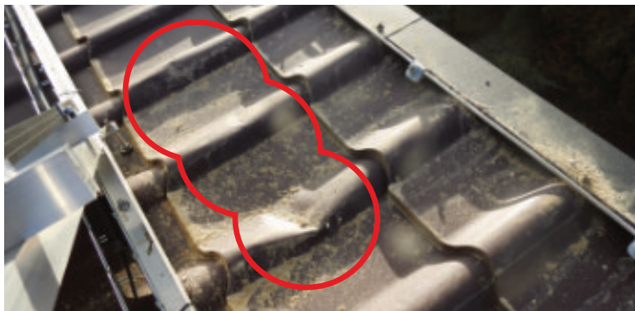
2. Promáčknutí plechové střešní krytiny vlivem zatížení při instalaci FV elektrárny. Zdroj: Satjam
