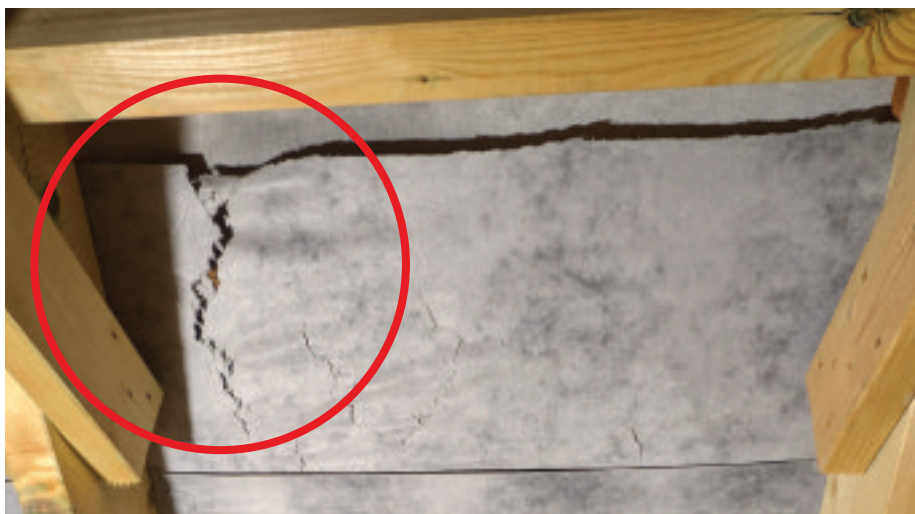
1. Poškození pojistné hydroizolační fólie při instalaci FV elektrárny na taškovou střechu. Foto: autor
