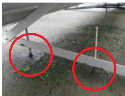
3. Poničení ploché střechy kvůli ne-respektování vlastností dotýkajících se materiálů. Zdroj: Bramac
